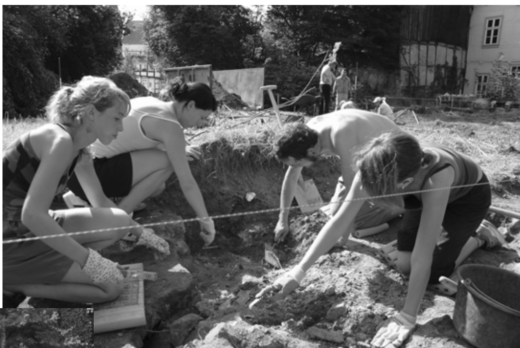
Architektur-Studenten der Technischen Universität Braunschweig legen unter Leitung von Bernhard Kruse den Grundriss der 1938 abgerissenen Halberstädter Synagoge frei. Nun kann mit der Gestaltung des Synagogenhofs begonnen werden. Foto: Jörg Endries
